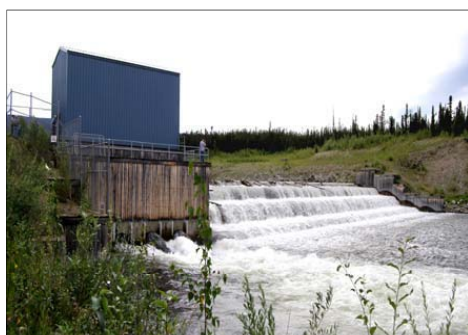
Mayo control structure
