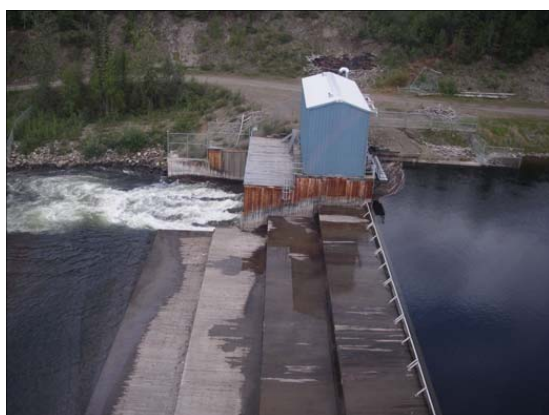
Mayo control structure
