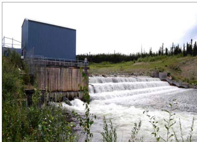
Mayo control structure
